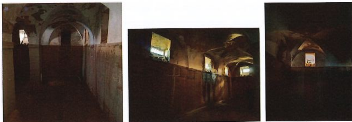
FIGURAS 15 A 17 – Fotografias do interior da arca d'água / cisterna da Mina do Palácio [Fonte: 'Adenda ao pedido de classificação das minas d'água da Ajuda – minas do Palácio e do Mirante, pp. 5 e 7]
