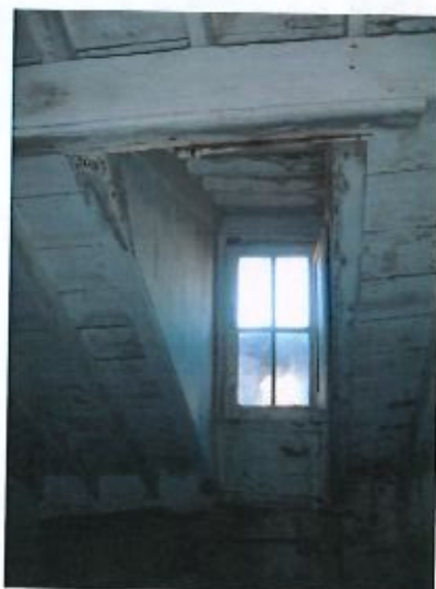
60. Interior de uma das divisões do sótão, com acesso ao vão de janela (05.11.2014).
