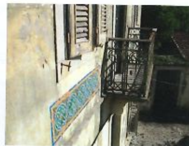
29. Estado de conservação dos azulejos e da guarda da varanda no corpo lateral direito antes das obras de conservação (05.11.2014).
