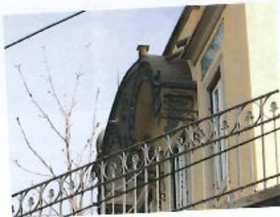
19. Pormenor da grade de proteção e da cobertura em ferro forjado sobre as janelas de sacada do corpo lateral (15.12.2016).
