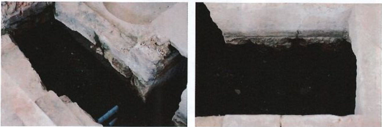
Figs. 53 a 54. Vestígios da presença de água no local. PM, 4.11.2021.
