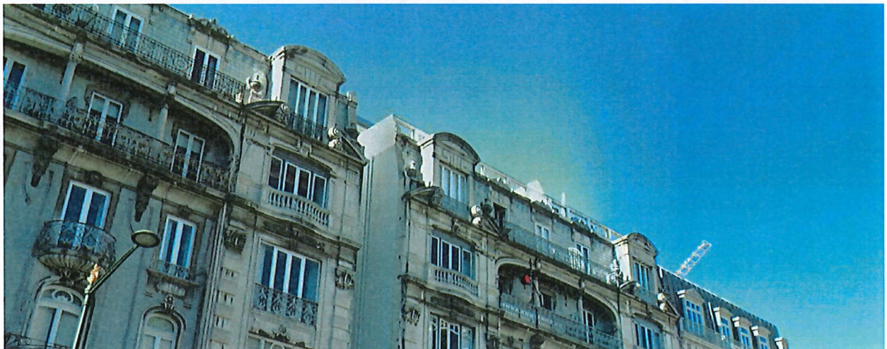
FIGURA 10 – Vista parcial das fachadas dos prédios em referência, de modo a evidenciar o impacto visual da balaustrada introduzida no 6.º andar do prédio com o n.º 84, quando observada a partir da rua. [Fonte: https://www.google.pt/maps ]
