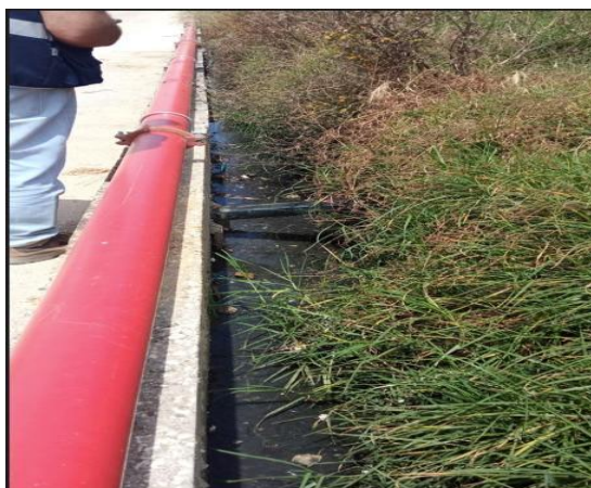
Foto 2 – Acumulação de lixiviados – canal de águas pluviais localizado na base do talude da Lagoa 4 (hexagonal) – visita em 09/05/2023
