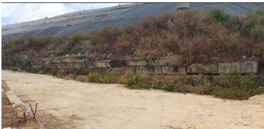
Foto 1 – Talude da Célula 1 – evidência de instabilidade estrutural – visita 09/05/2023
