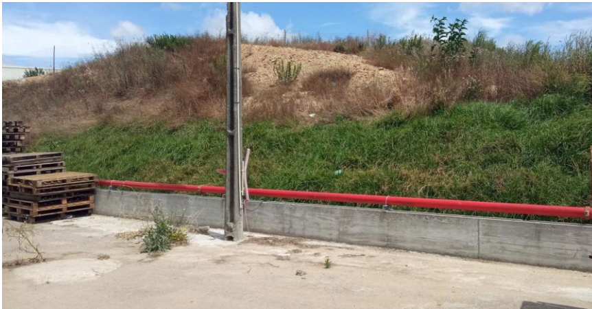
Foto 4 – Acumulação de lixiviados – canal de águas pluviais localizado na base do talude da Lagoa 4 (hexagonal) – visita em 09/05/2023
