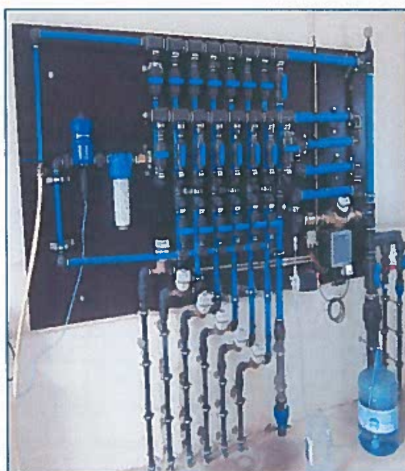
Figura 11 – Controlo do consumo de água do furo
