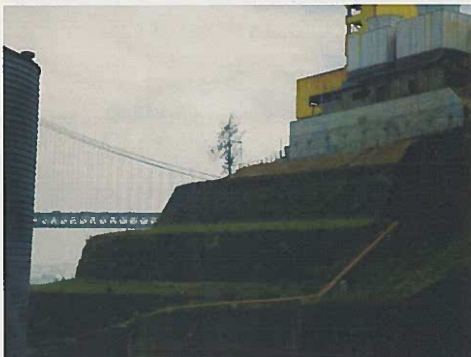
Intervenções para estabilização da arriba, situadas a poente do local do projeto Sovena XXI, sob as atuais instalações da Sovena Oilseeds.
