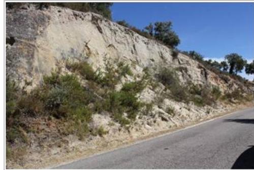
Figura 60 - Desabamento de terras em talude de estrada
