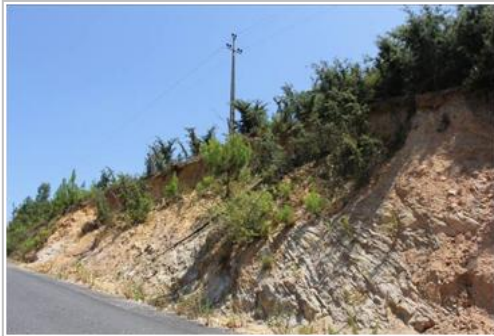
Figura 59 - Deslizamento superficial em talude de estrada
